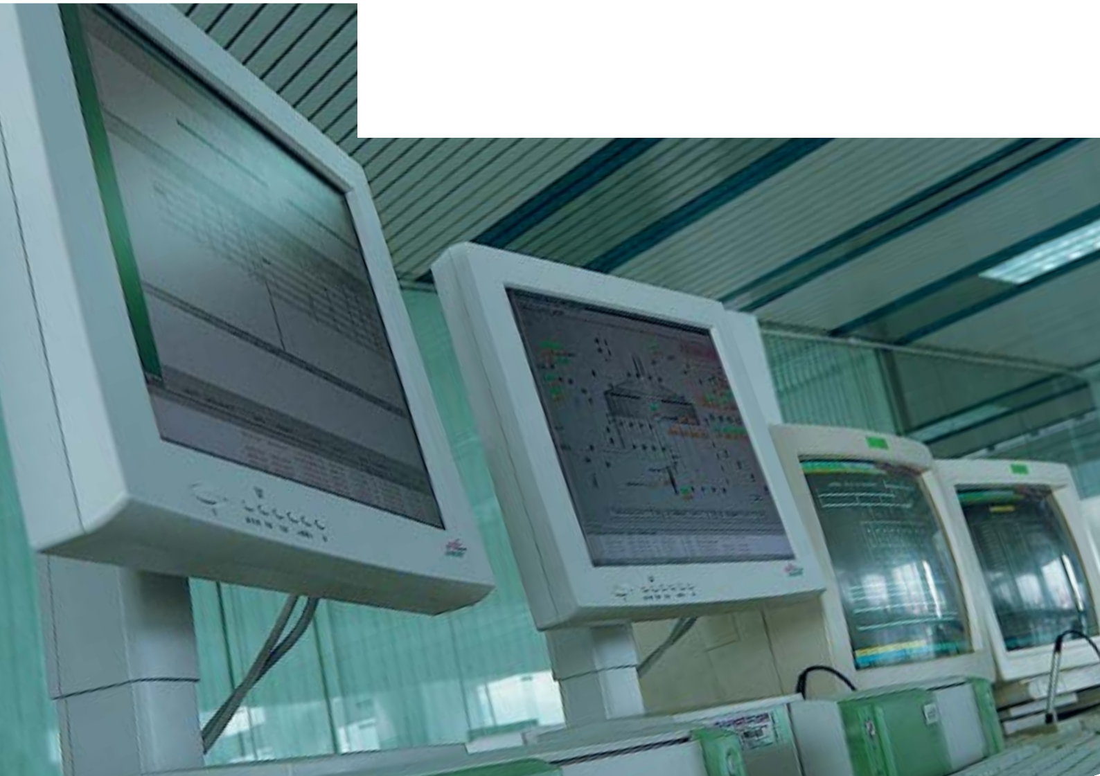
Sala de Control Cocimiento - Planta Ate
